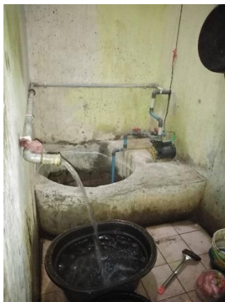
Gambar 4. Air yang keluar dari sumur cincin
